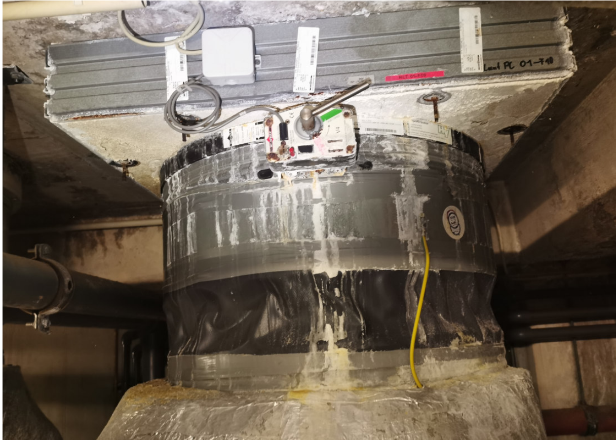
Brandschutzklappe durch die Undichtigkeit im Beckenumgang komplett defekt
