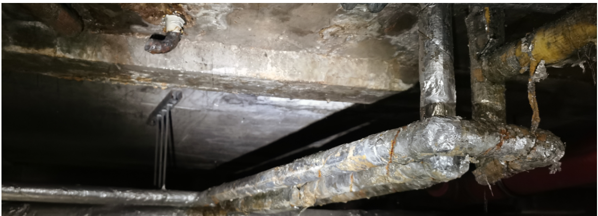
Heizung / Wasserleitung unterhalb von undichten Stellen
